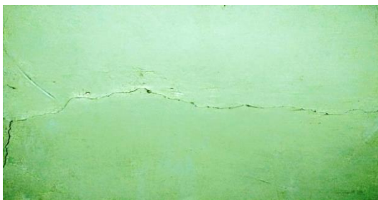
Fig. 3. (b) Thin crack (<1mm)
